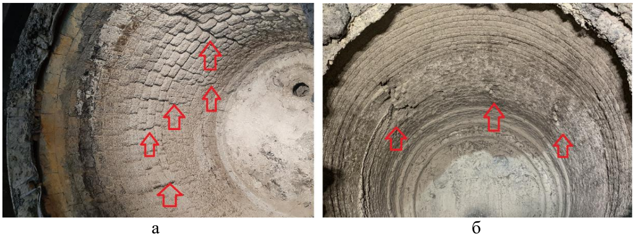
Рисунок 20. Локализация областей разрушения в оборудовании малого, диаметр 1,5 м (слева) и большого, диаметр 5 м (справа) размера.
