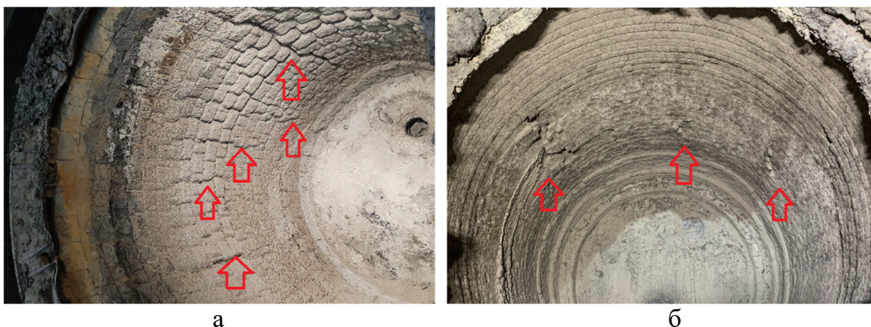
Рисунок 3. Локализация областей разрушения в оборудовании малого, диаметр 1,5 м (слева) и большого, диаметр 5 м (справа) размера.
