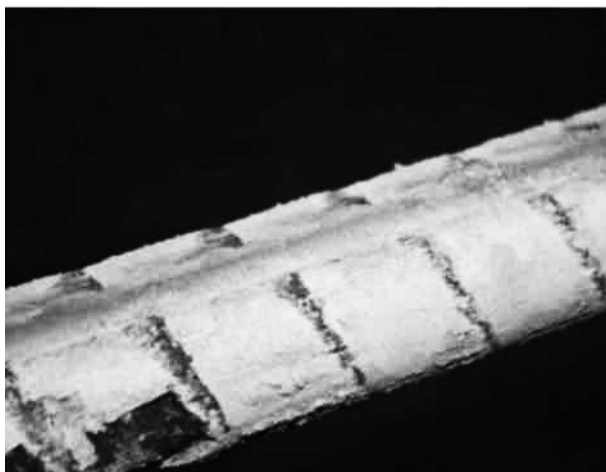
Рис. 1.5. Общий вид вытянутой из бетона арматуры [5]
