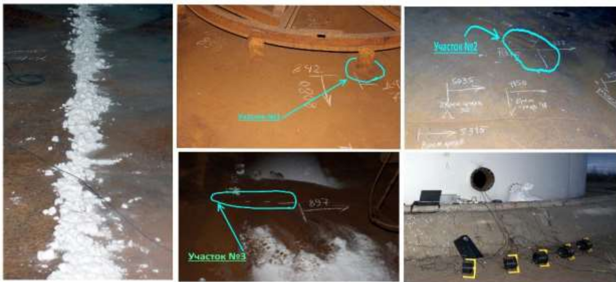
Рис. 4.12 - Обнаруженные источники АЭ при локальном низкотемпературном нагружении днища резервуара
