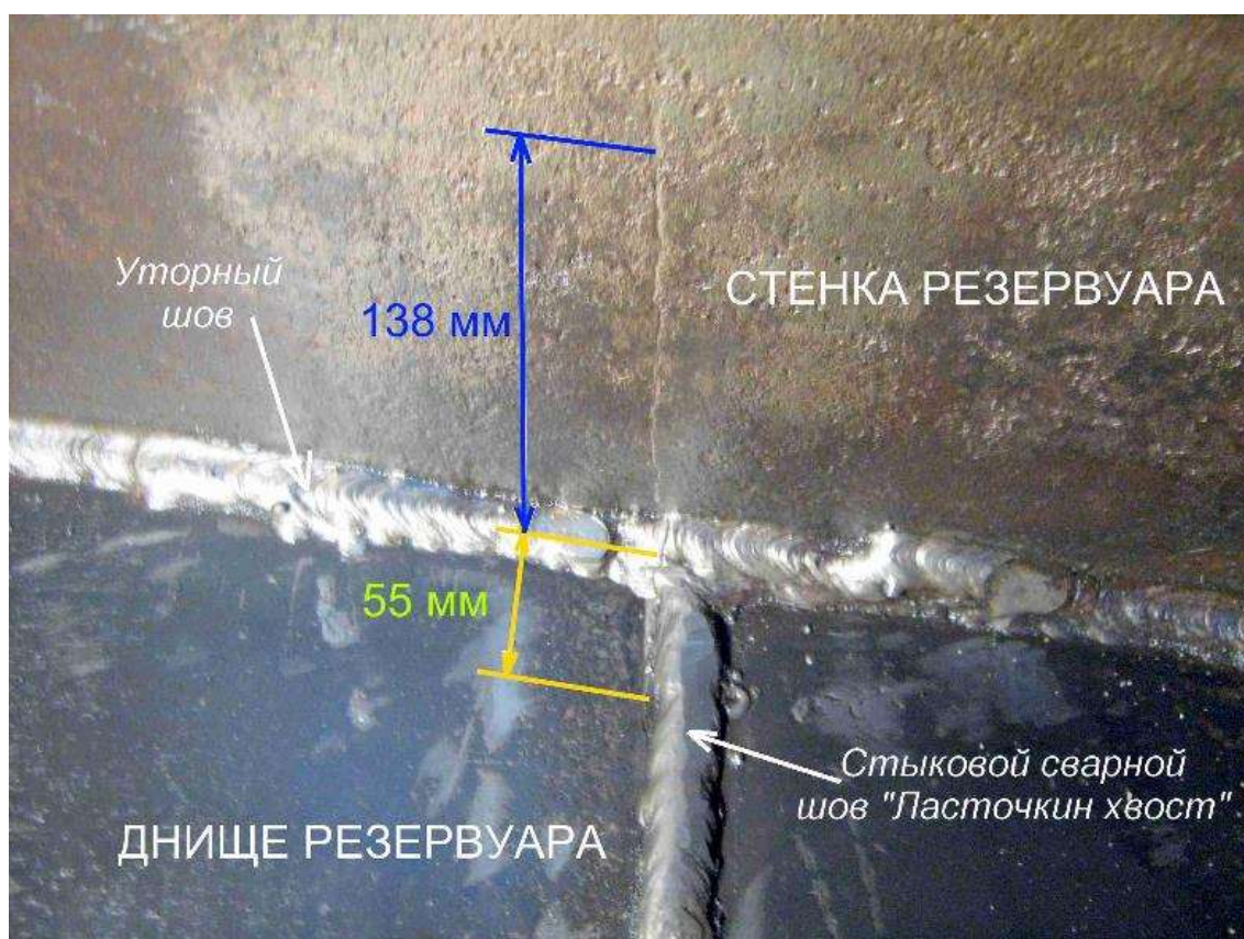
Рис. 2.5. Трещина №1 в зоне уторного соединения резервуара, вид с внутренней стороны резервуара
