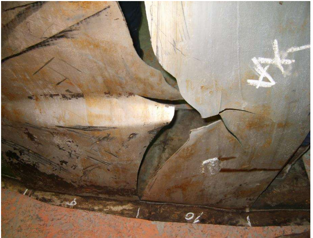
Рис. 2.20. Общий вид начала разрушения
