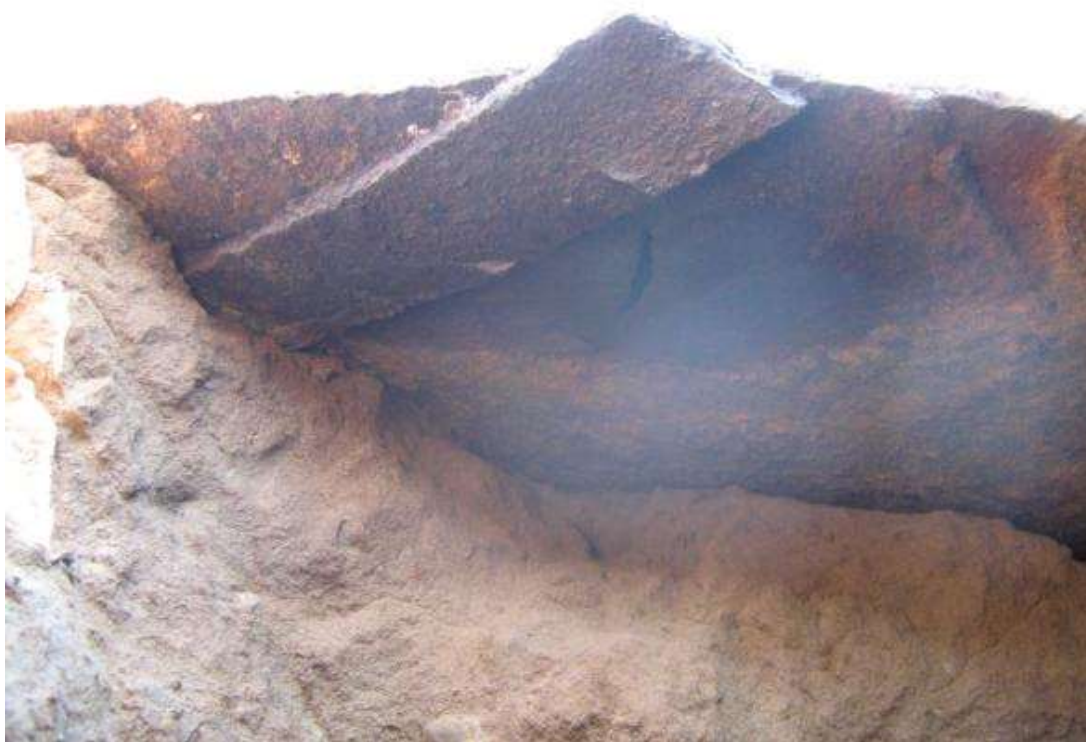
Рис. 2.11 - Трещина с наружной (нижней) стороны днища
