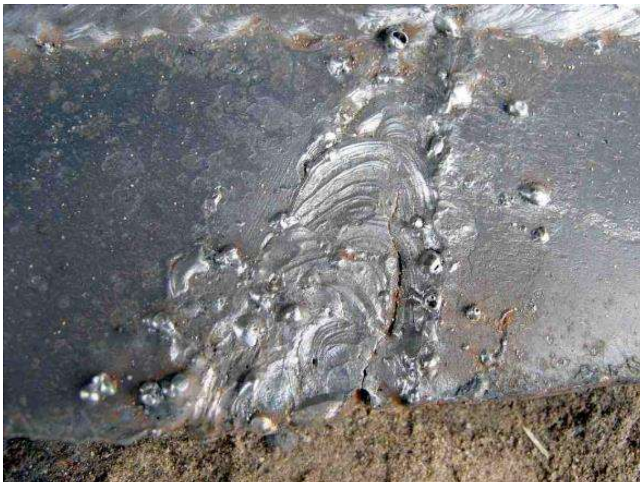
Рис. 2.8. Трещина №3 с наружной стороны окрайки днища резервуара
