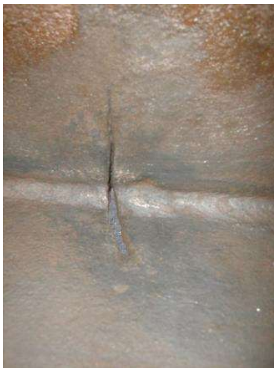
Рис. 2.10 - Трещина с внутренней стороны резервуара
