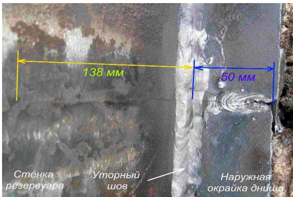
Рис. 2.4. Трещина №1 в зоне уторного соединения резервуара, вид с наружной стороны резервуара
