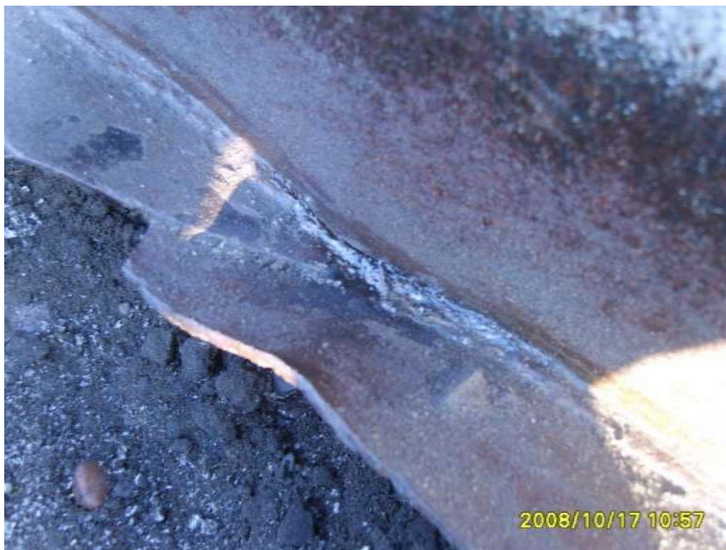
Рис. 2.15. Трещина по уторному (днища и стенки) сварному соединению РВС-700№9
