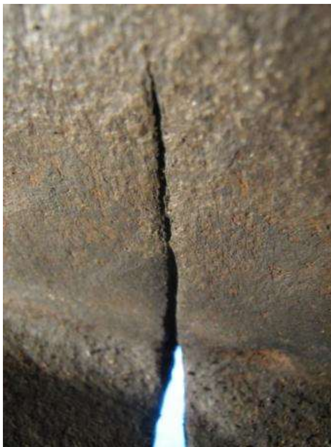
Рис. 2.12 - Трещина на внутренней стороне стенки
