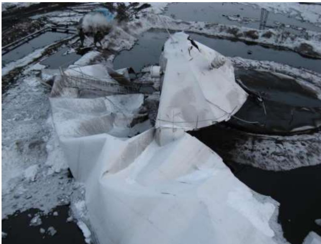
Рис. 2.22. Общий вид разрушения резервуара РВС-700 №49
