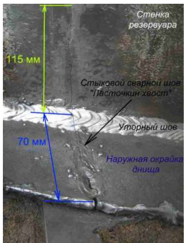
Рис. 2.6. Трещина №2 в зоне уторного соединения резервуара, вид с наружной стороны резервуара
