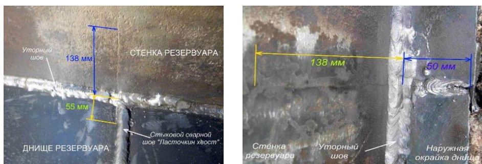
Рисунок 2- Повреждения резервуара с розливом нефтепродукта
